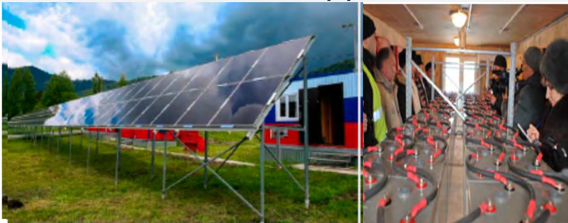
Автономная СЭС, 100 кВт, с. Яйлю, Республика Алтай, 2013.
