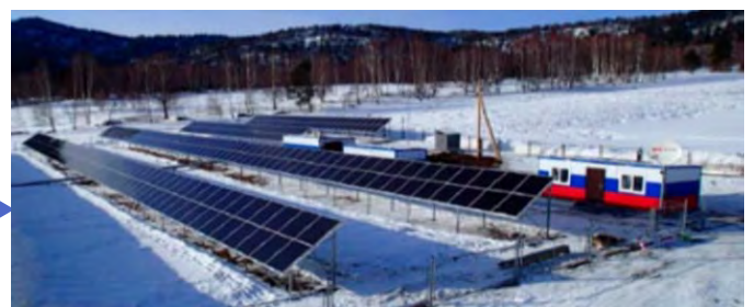
Автономная солнечно-дизельная энергоустановка.
